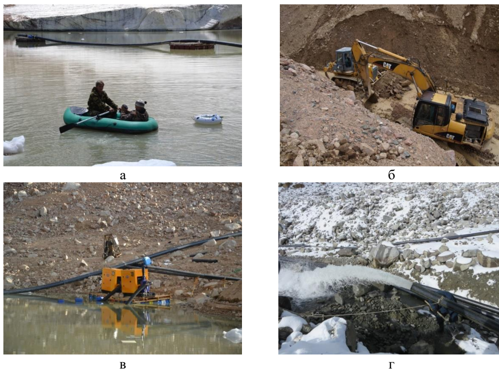
Рис. 1. Работы по превентивному опорожнению моренных озёр. а – батиметрическая съёмка с использованием эхолота и GPS-навигатора, б – прокладка поверхностного канала с использованием экскаватора и бульдозера, в – насос для откачки воды насосами, смонтированными на плавучей платформе, г – сброс воды сифоном
